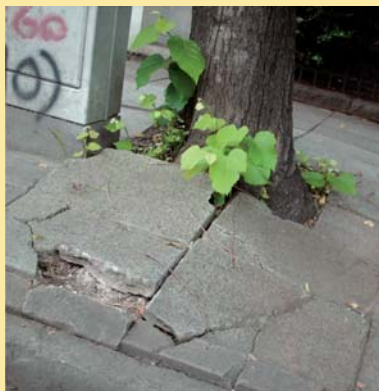
Un caso extremo de falta de espacio
